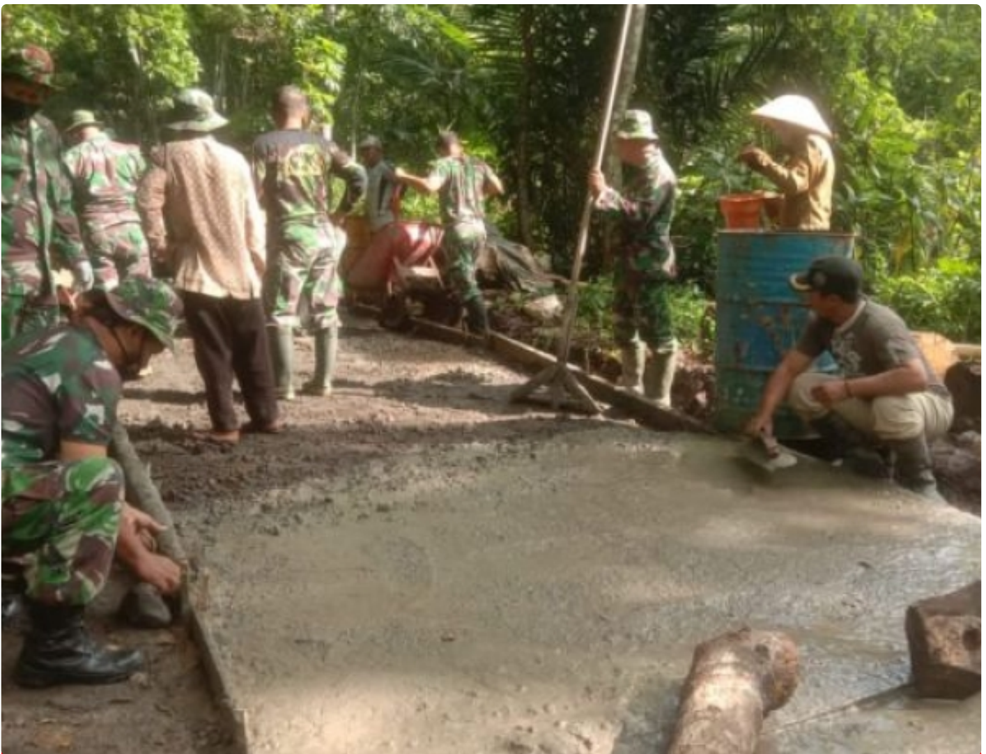
Satgas TMMD Kodim 0705/Magelang Bersama Masyarakat Kebut Pengecoran Jalan Di Desa Balesari
